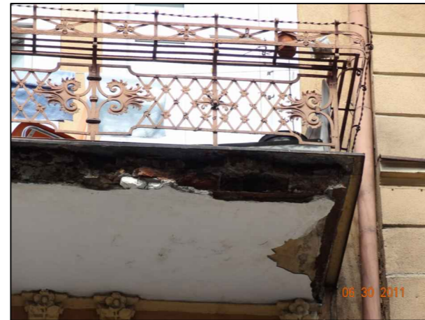
USZKODZONE CZOŁO BALKIONU
